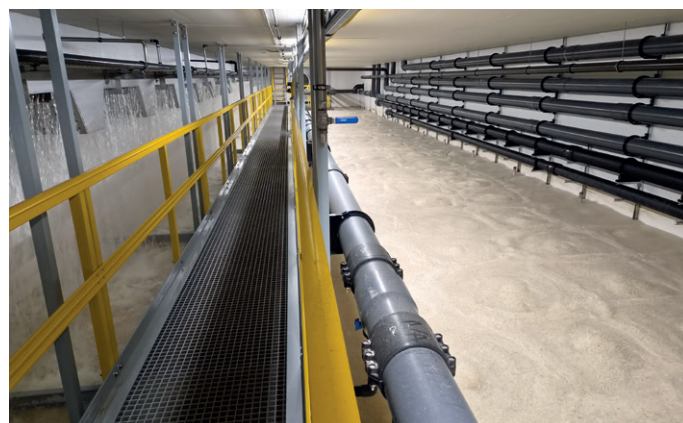
Det store biofilteret for utskilling av slam i underetasjen.
